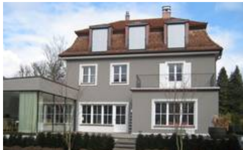
Voll im Trend liegen bei Putzfassaden derzeit dezente Farbtöne wie Rosé oder Hellgrau. Nach wie vor der „Dauerbrenner“: die Farbe Weiß. Bild: tdx/Homathern
